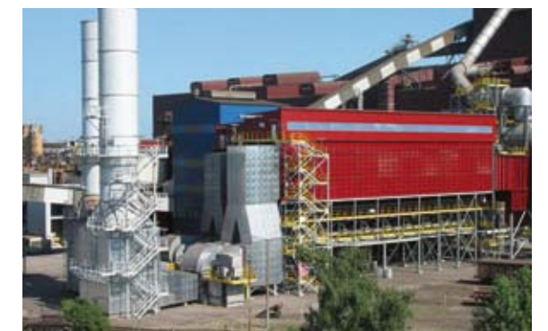
Stahlwerk SIEMENS VAI Linz, ausgestattet mit REITZ Ventilatoren zur Sekundärentstaubung. Foto: Siemens VAI, Linz
